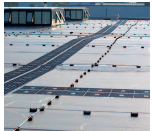
Wartungswege mit Gehwegplatten aus Kunststoff
